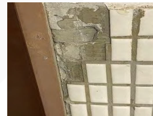
教室外牆磁磚剝落
