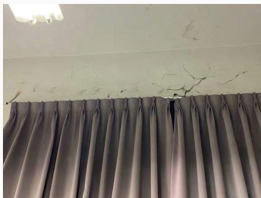
教室牆地因地震龜裂嚴重
