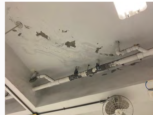
教室天花板多處漏水
